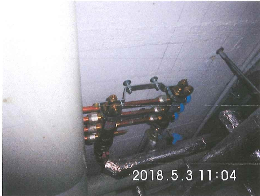
Bild 5032: Fußbodenheizungsverteiler augenscheinlich neueren Datums
