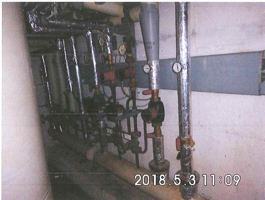
Bild 5045: Streitgegenständliche Absperrventile in Form von Kugelhähnen
