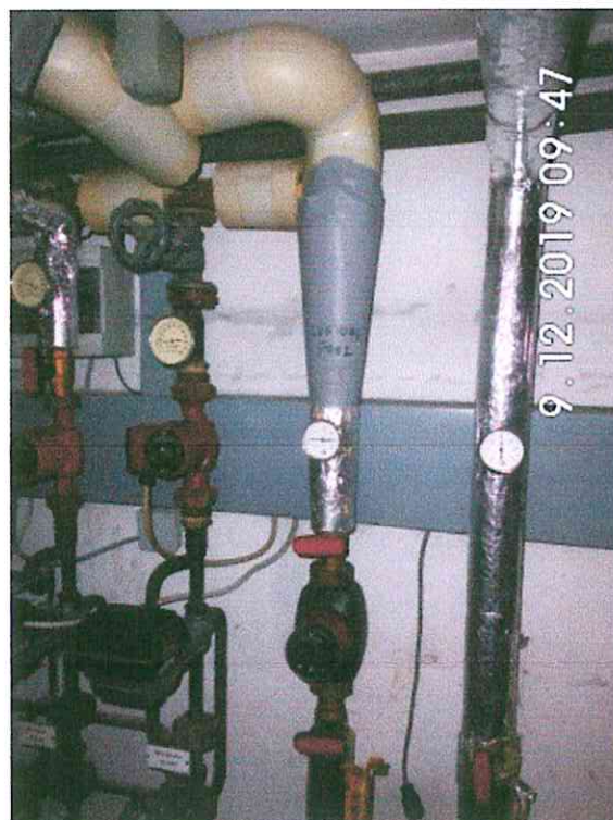
Bild 1467: Rohrleitung Lüftung an einen separaten Anschluß an den Verteiler angeschlossen Gutachten für: Landgericht Koblenz, Aktenzeichen: 8 OH 2/19, Herkenrath, K. u.a. / J. Berndt, H.
