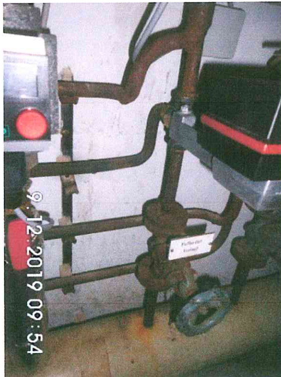
Bild 1473: Fußbodenheizung ebenfalls mit separatem Anschluß an den Verteiler
