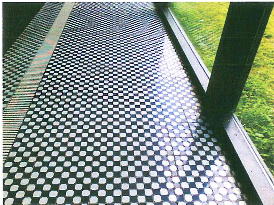
Bild 2723: Fußbodenfläche in der Schwimmhalle durch Fußbodenheizung beheizt
