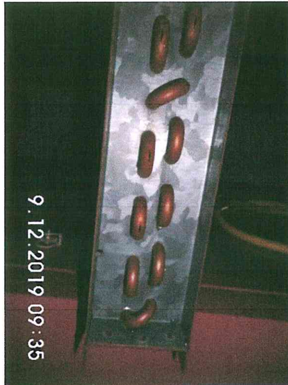
Bild 1466: Frostschäden an Umlenkungspunkten innerhalb des Heizregisters
