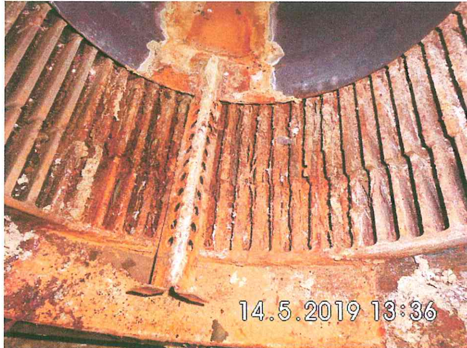
Bild 9343: Brennraum Heizkessel 63kW Korrosion an Rippe
